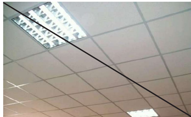
Плохо Открытые направляющие
